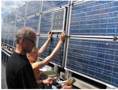
Figure 5: Measuring irradiance at the Huvudsta system.
